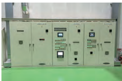
◆ システム制御盤
